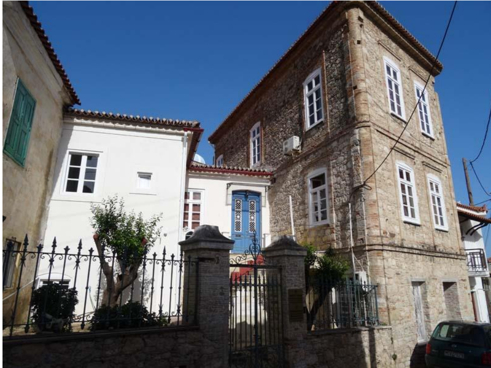
Κτήριο Μόραλη (Γραφεία Καθηγητών Τμήματος Μαθηματικών) (Προσωρινά μη διαθέσιμο λόγω του καταστροφικού σεισμού που έπληξε τη Σάμο τον Οκτώβριο του 2020)
